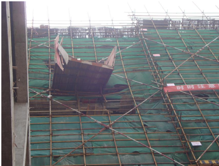
图 17-1 发生事故的悬挑钢平台
